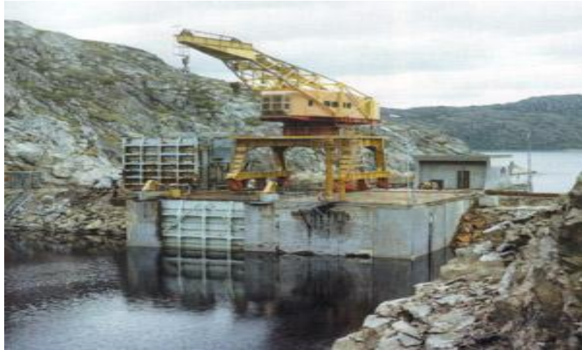
Кислогубская приливная электростанция.
